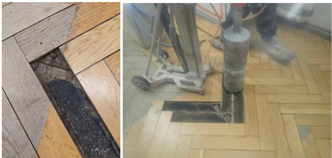
Kuva 33. Bitumiliimakerros ei ollut yhtenäinen parketin alla. Parkettia poistettiin ennen näyteliäriöiden irrotusta.
