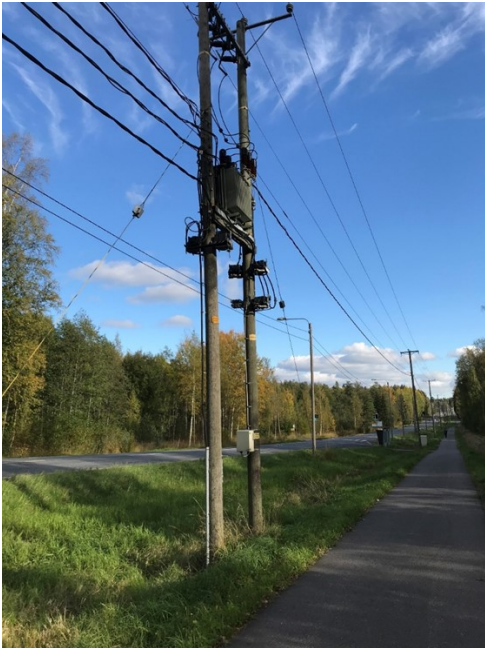
Kuva 25. 20 kV/400 V:n pylväsmuuntamo.
