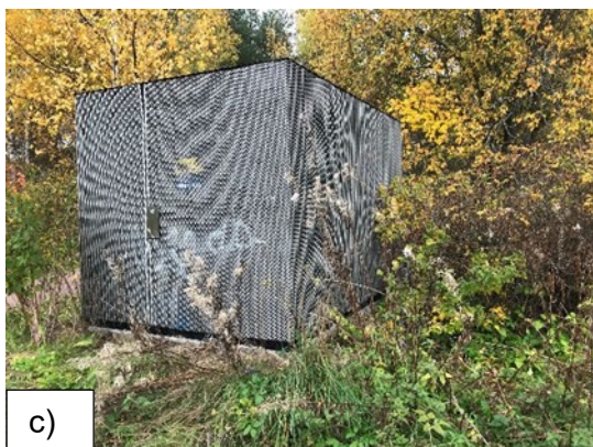
Kuva 20. Puistomuuntamoita. a) Muuntamo 1, 630 kVA, b) Muuntamo 2, 800 kVA ja c) Muuntamo 3, 800 kVA.
