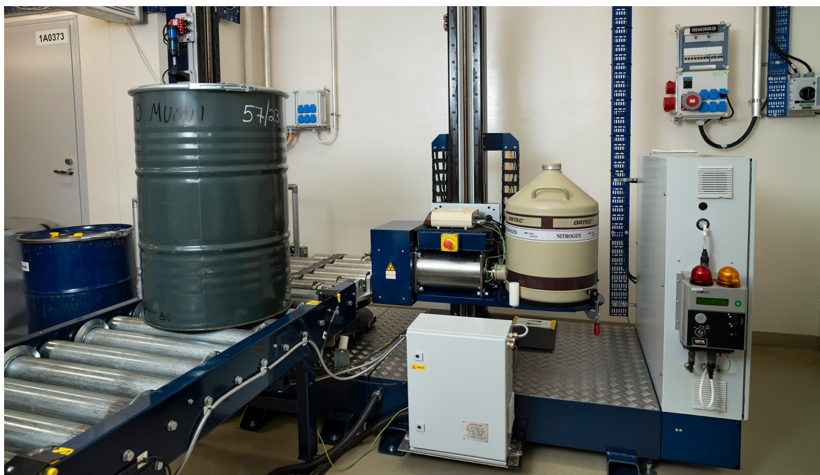
KUVA 6. Loviisan ydinvoimalaitoksella käytössä oleva tynnyrimittauslaite. Laitteella saadaan määritettyä tynnyreihin pakattujen jätteiden eri radionuklidien aktiivisuudet. Kuva: Fortum, Loviisan voimalaitos.
