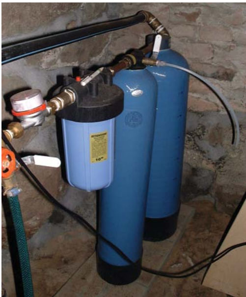
Kuvassa näkyvässä asennuksessa on anioninvaihdin uraanin poistoon esisuodattimen ja aktiivihiilisuodattimen välissä.
