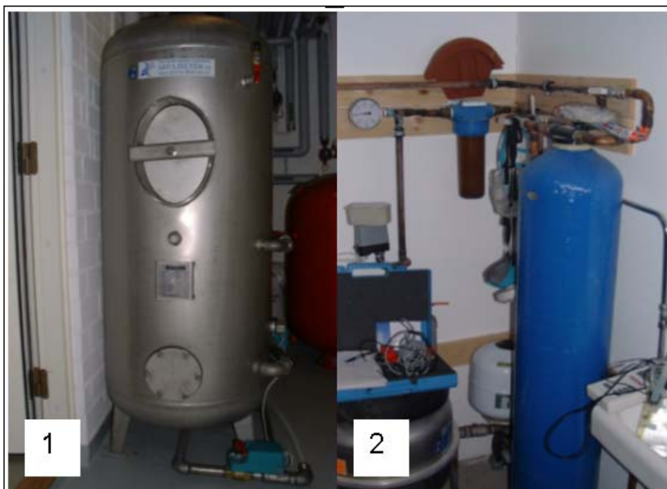
Kuva 7. Tässä Tekes hankkeessa testatut radonin, raudan ja mangaanin samanaikaiseen poistoon soveltuvat laitteet: 1 Akva FilterOy:n laite, 2 Oy WatMan Ab:n laite.
