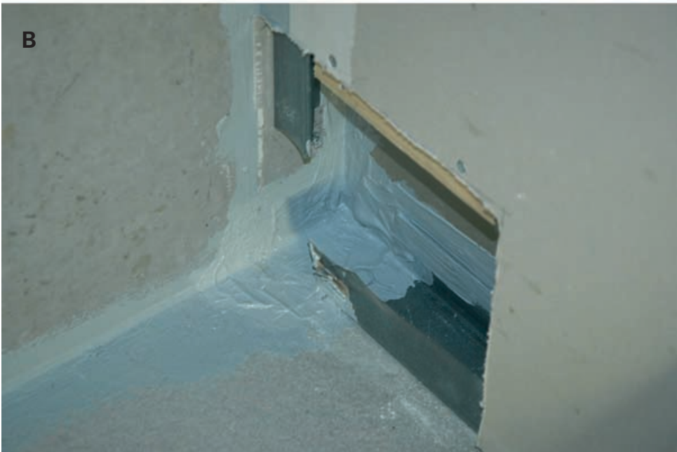
Kuvat 6.4. Vedeneristysmassalla tehty tiivistystyö väliseinän sisällä. Kuvassa perusmuurin ja laatan välissä oleva solumuovinen eristysnauha ei estä radonpitoisen ilman vuotoja.
