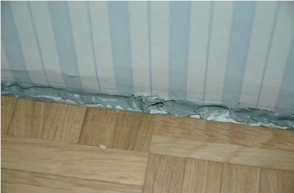
Kuva 6.2. Epäonnistunut tiivistäminen, jossa lattialistan alla olevaa saumattavaa rakoa ei avarrettu ja puhdistettu.
