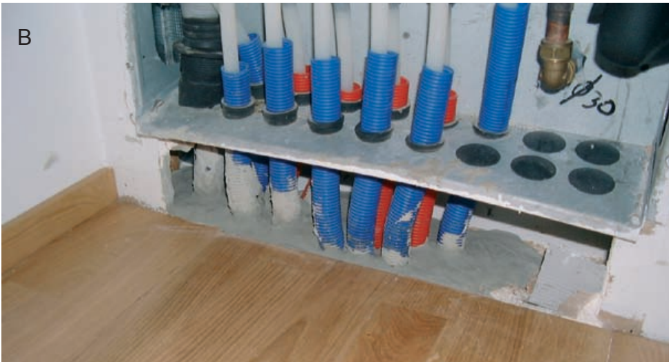
Kuva 6.6. Tiivistämätön läpivienti pientalossa vesijohtojen jakotukin yhteydessä. Suoja-putkien välistä oli suora yhteys lämmöneristeeseen ja täyttösoraan (A). Tiivistystyö suoritettiin erittäin juoksevilla tasoitemassalla (B).
