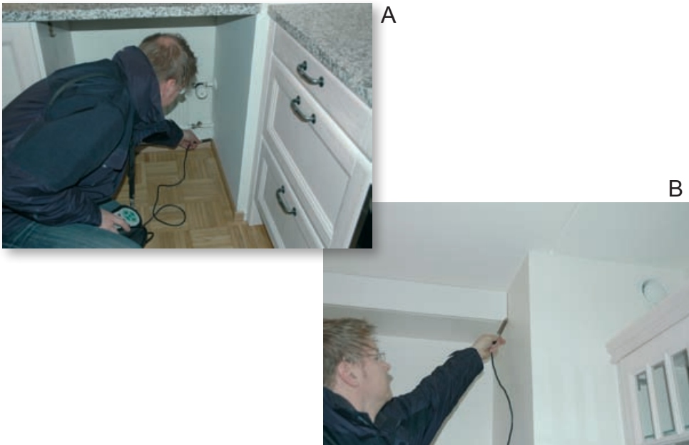
Kuva 12.4. Vuodon etsintää lattia- ja putkistokanavan liitoksesta (A). Myös lattia- ja seinän välinen rako oli vuotava. Vesi- ja viemäriputkikanava osoittautui merkittäväksi vuotoreitiksi. Putkikanava on yhteydessä ilmanvaihtokotelointiin, jota myöten radonpitoinen ilma leviää muihin tiloihin (B).
