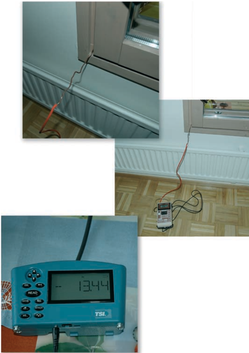
Kuva 12.2. Alipaineen mittaamiseen käytettäviä mikromanometrejä. Alipaine ulkoilmaan nähden mitataan ikkunan raosta kulkevan ohuen putken avulla.
