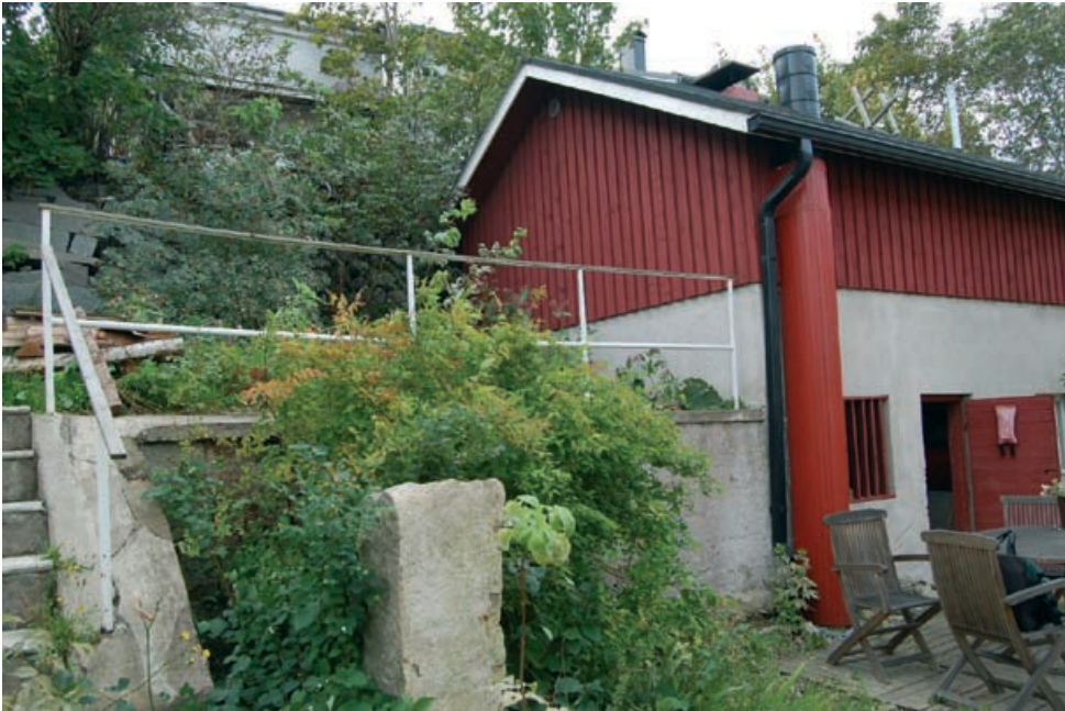
Kuva 5.11. Radonkaivon poistoputki vajan seinustalla Pispalanharjulla.
